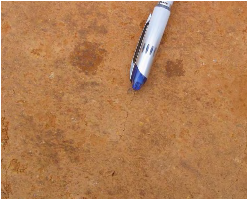
ภาพที่ 7 ภาพแสดงรอยแตกขนาดเล็กในชั้นพื้นทางดินซีเมนต์โครงการก่อสร้างทางหลวงหมายเลข 3510
