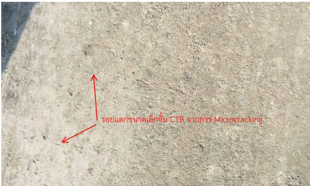
ภาพที่ 27 ภาพแสดงรอยแตกขนาดเล็กบนชั้น CTB ที่เกิดขึ้นจากการ Microcracking ด้วยรถดล้อเหล็กแบบสันสะเทือน
