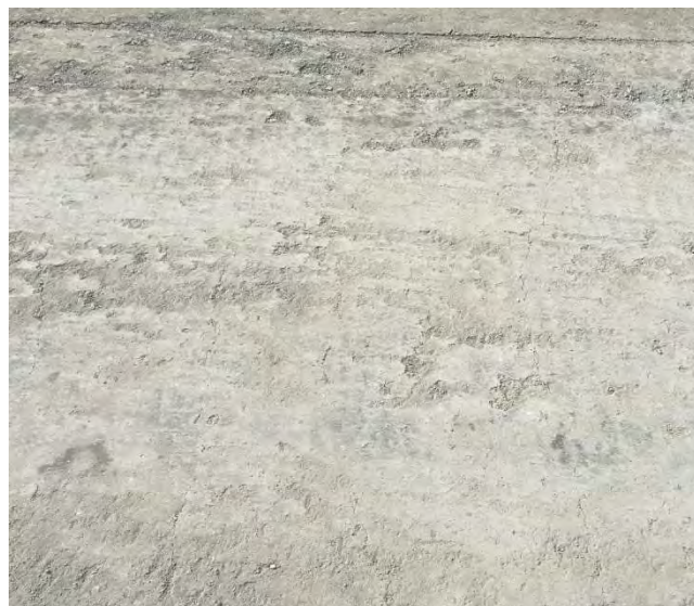
ภาพที่ 30.4 รอยแตกขนาดเล็กบนชั้น CTB ที่เกิดขึ้นจากการ Microcracking ด้วยรถบดล้อเหล็กแบบสันสะเทือน
